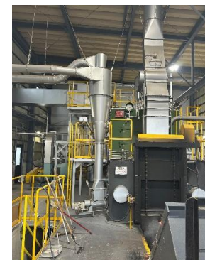
蒸気発生用ボイラ
