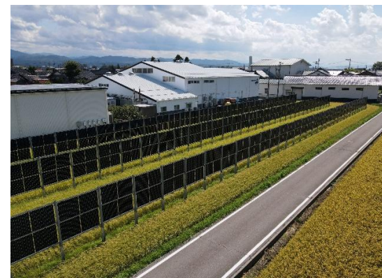
太陽光発電設備(垂直型ソーラーシステム)
