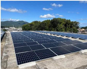
太陽光発電設備
