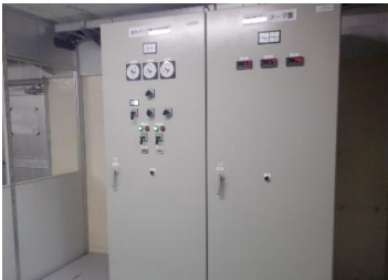
動力制御盤、計装盤
