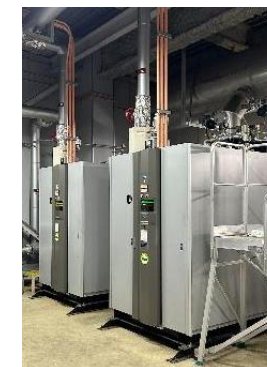
ガス焚き蒸気ボイラ
