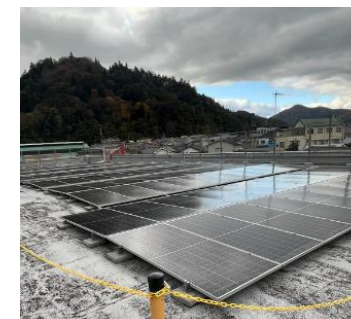
太陽光発電設備
