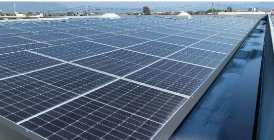
太陽光発電設備
