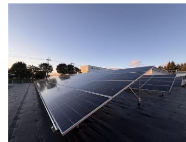
太陽光発電設備
