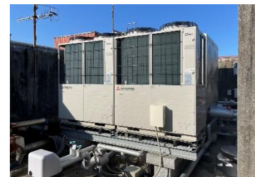
ヒートポンプ給湯機
