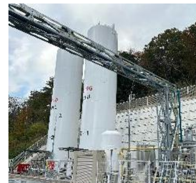
LNGサテライト
