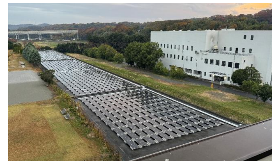
太陽光発電設備
