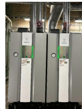
ガス炊き蒸気ボイラ
