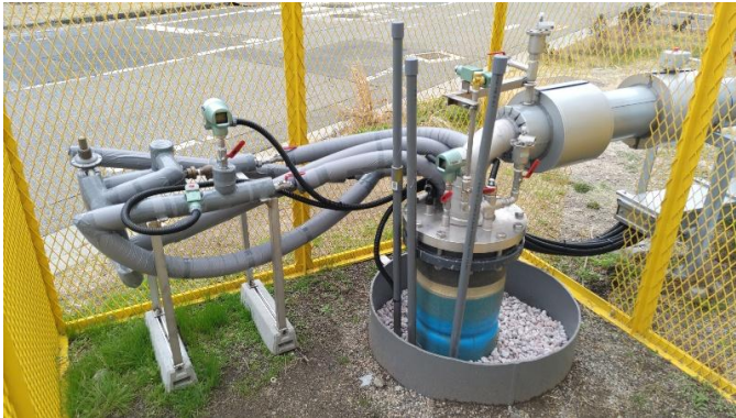
帯水層蓄熱システムの熱源井
