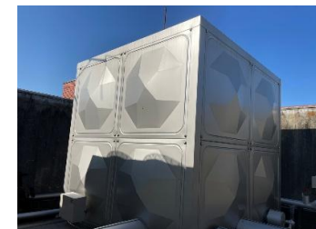
開放型貯湯槽
