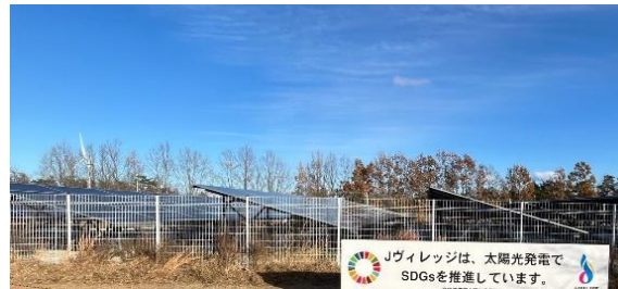
太陽光発電設備①
