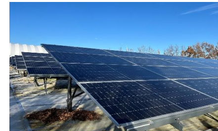
太陽光発電設備②
