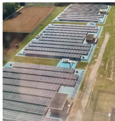
太陽光発電設備
