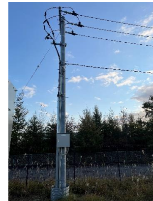
自営線電柱近景
