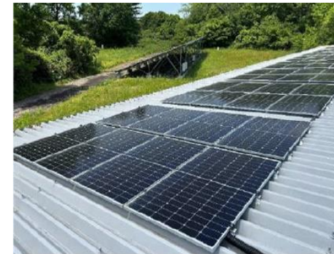
太陽光発電設備
