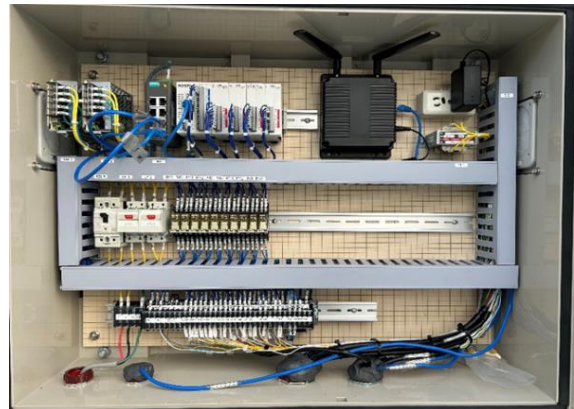
空調最適制御システム（制御盤）
