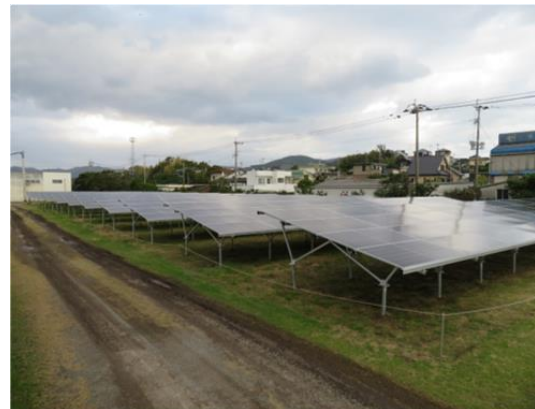
太陽光発電設備
