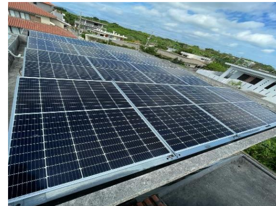
太陽光発電設備②
