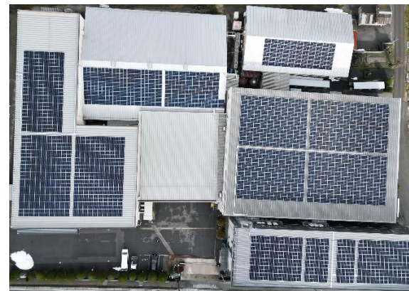
太陽光発電設備
