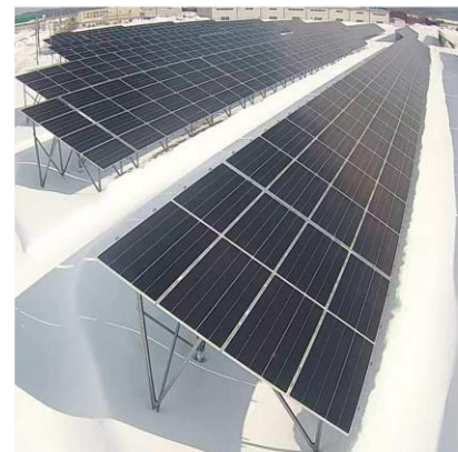
太陽光発電設備
