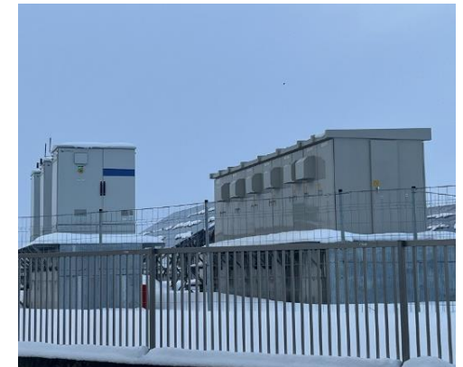
蓄電池（左）、キュービクル（右）
