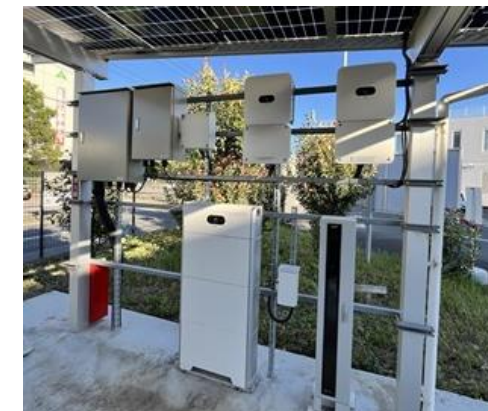
パワーコンディショナー・蓄電池
