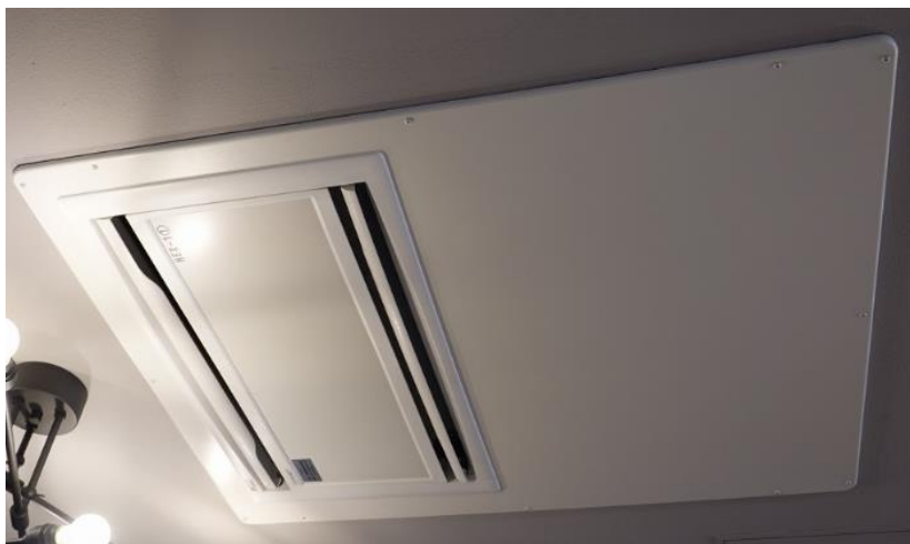
高機能換気設備（全熱交換器）
