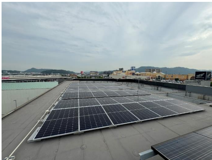
太陽光パネル
