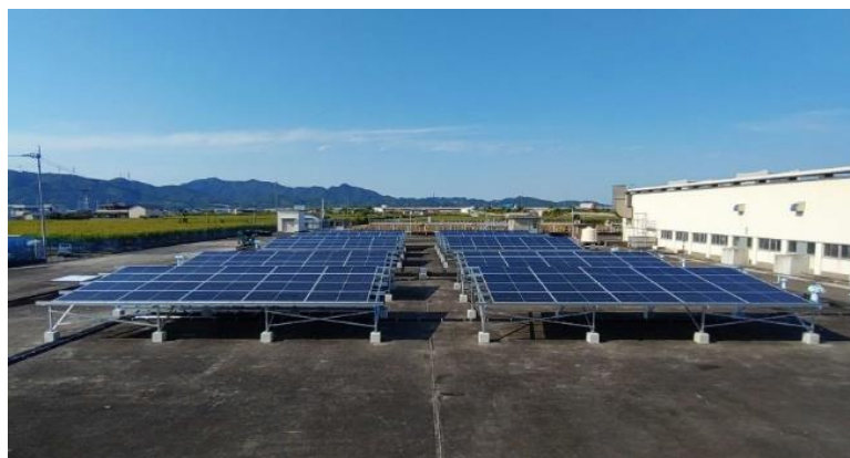
太陽光発電パネル設置後の状況 （事業実施後）
