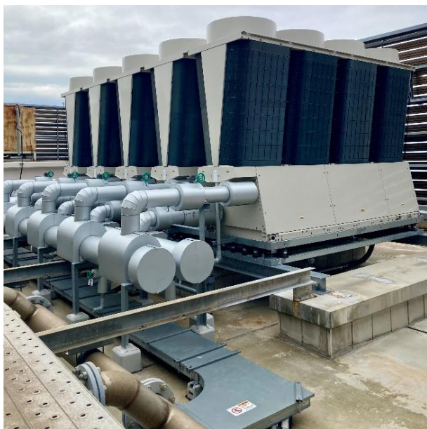
空調設備（ヒートポンプチャラー）
