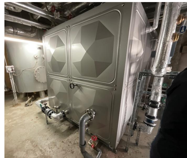
開放型貯湯槽
