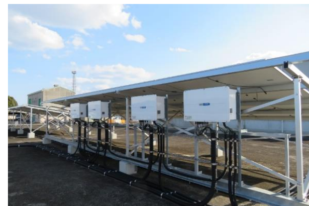
パワコンの設置状況
