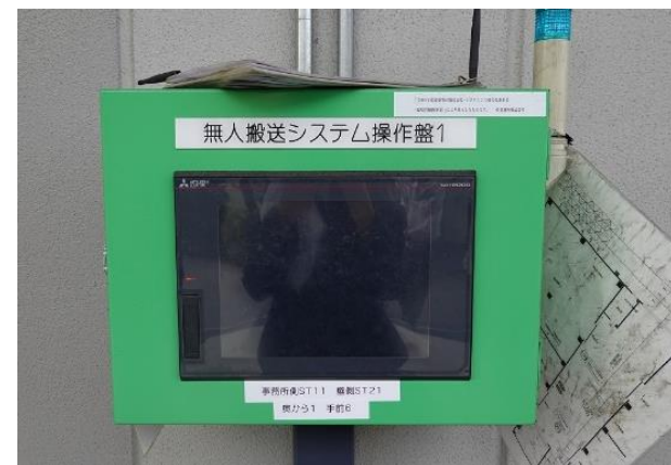
無人輸送システム操作盤
