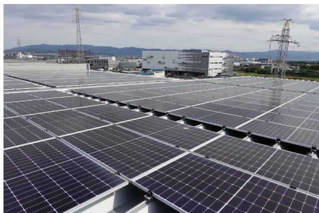
太陽光パネル
