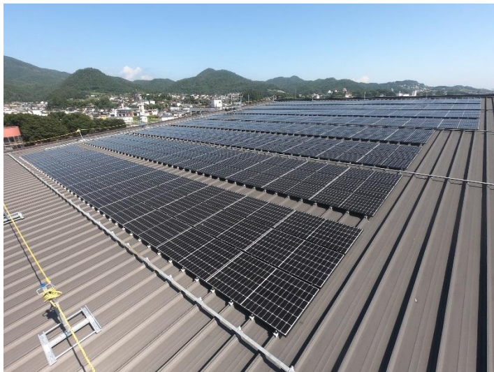
太陽光発電設備
