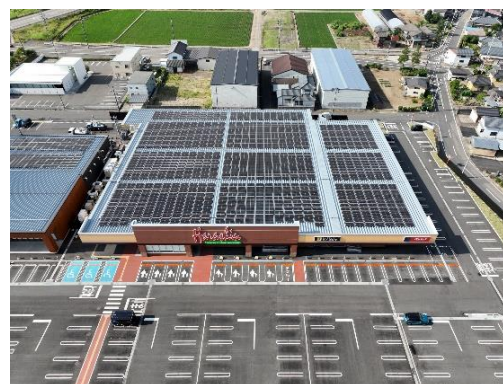
太陽光発電設備
