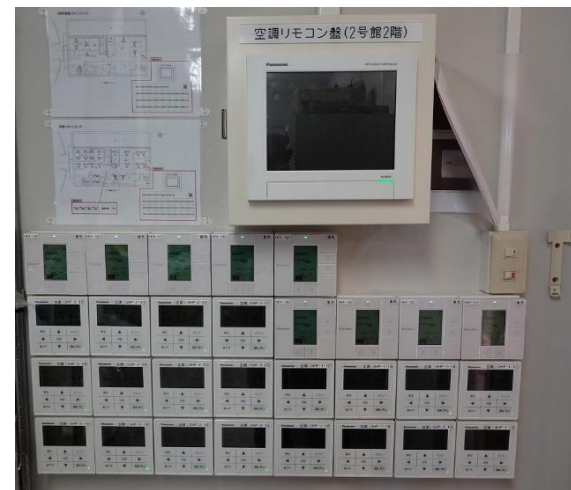
高効率空調 コントロールパネル
