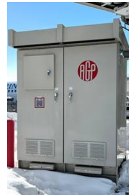
電力変換装置
