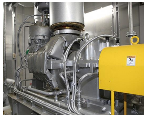
蒸気タービン発電機
