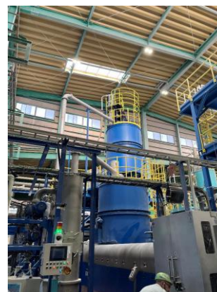
メカニカルリサイクル設備
