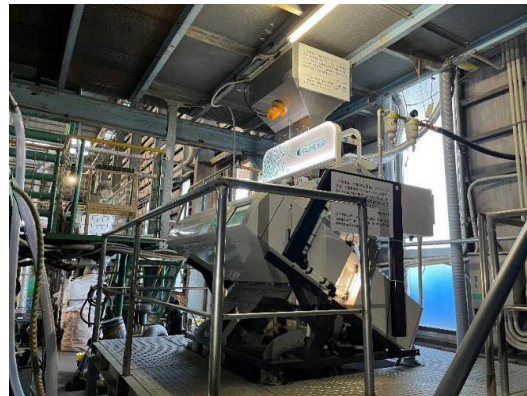
高度PETフレーク異物除去装置設備
