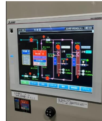
熱回収ヒートポンプ制御盤
