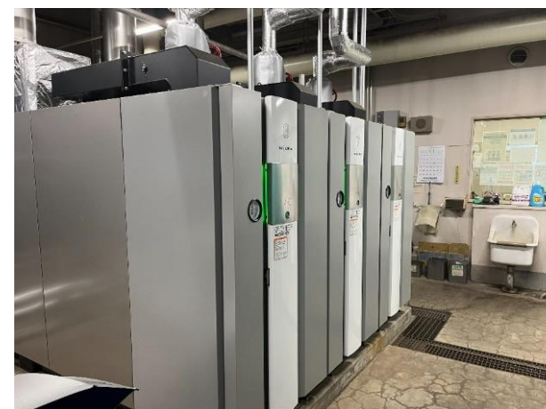
ガス焚き蒸気ボイラー
