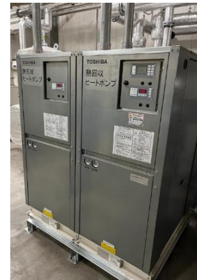
熱回収ヒートポンプ設備
