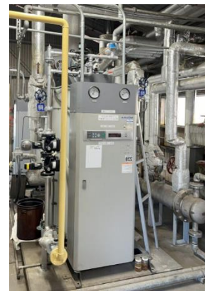
高性能ボイラー
