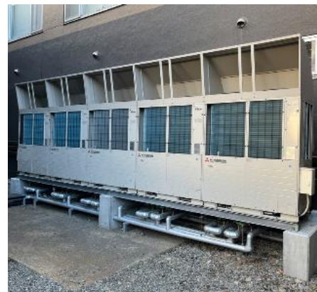
ヒートポンプ給湯機
