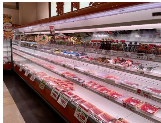
冷凍冷蔵設備
