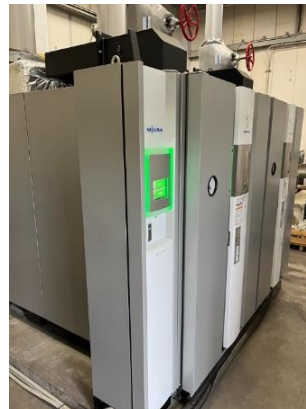
都市ガス式ボイラー設備
