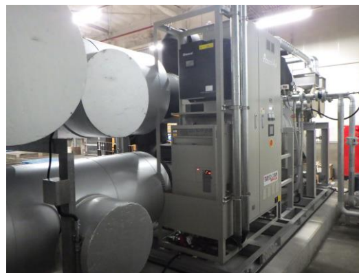
冷凍機ユニット
