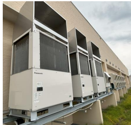
CO 2 冷媒冷凍機
