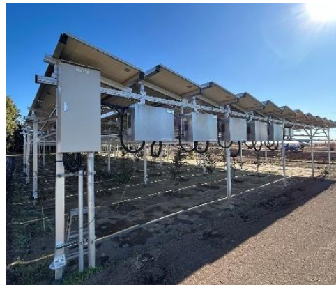
太陽光発電設備
