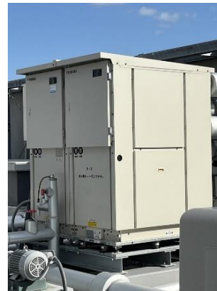
空冷＆水冷式ヒートポンプチャラー
