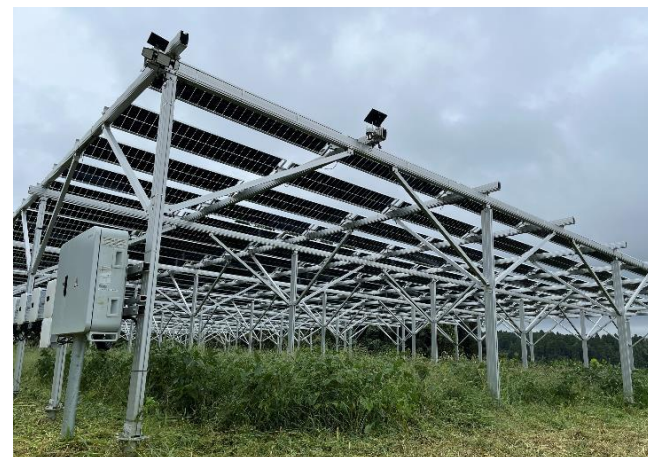
太陽光パネル
