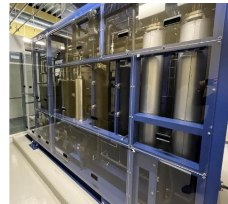
水素製造装置
