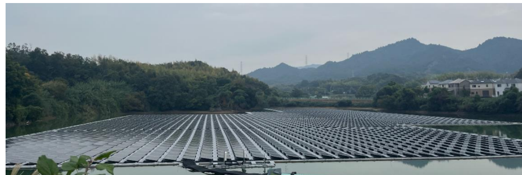
水上太陽光発電設備
