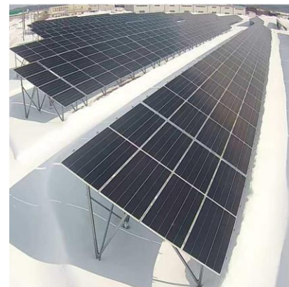
太陽光発電設備
