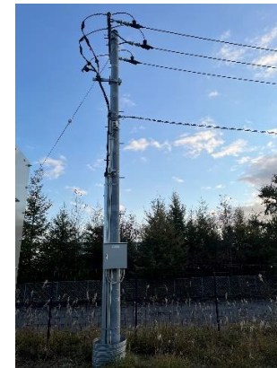
自営線電柱近景
