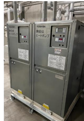
熱回収ヒートポンプ設備
