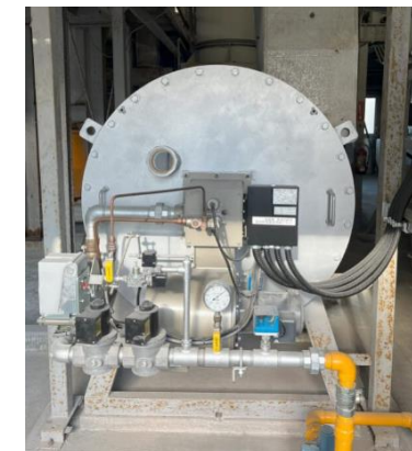
高性能熱風発生炉
