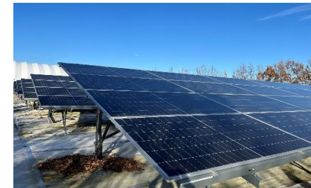
太陽光発電設備②
