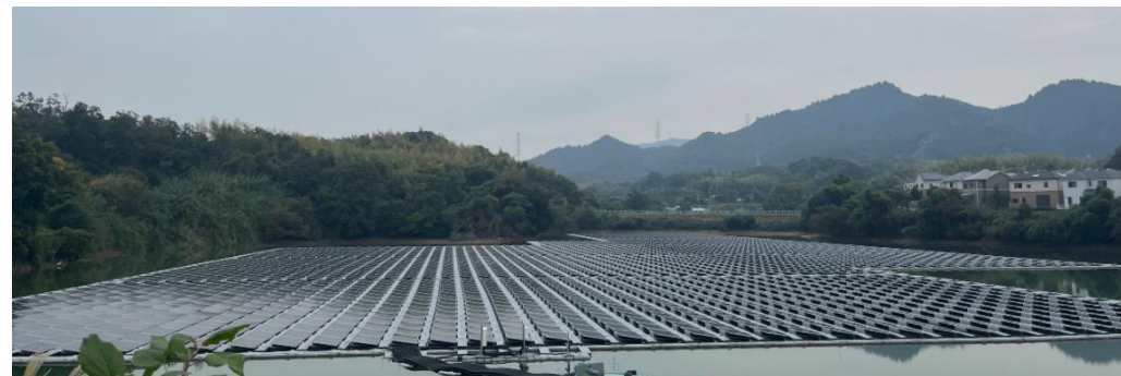
水上太陽光発電設備
