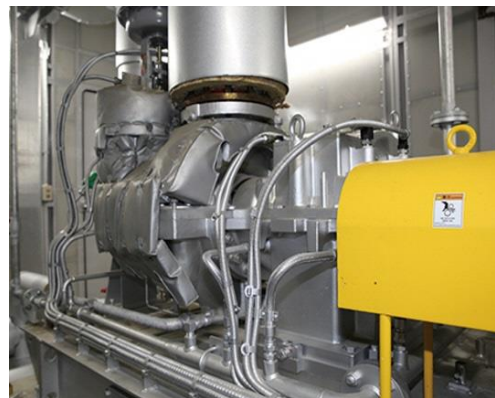
蒸気タービン発電機
