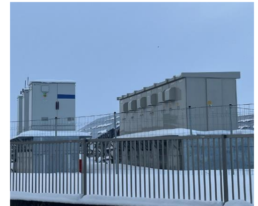
蓄電池（左）、キュービクル（右）
