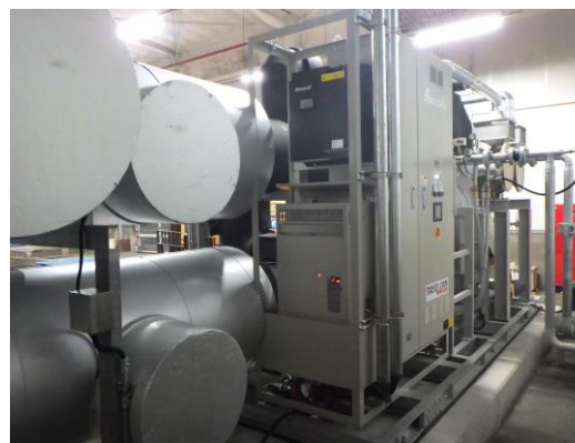
冷凍機ユニット
