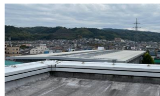
太陽光 発電設備
