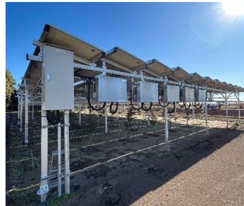
太陽光発電設備
