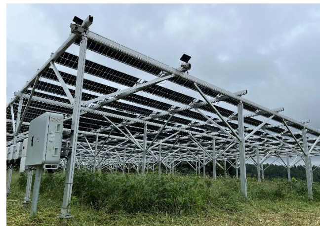
太陽光パネル
