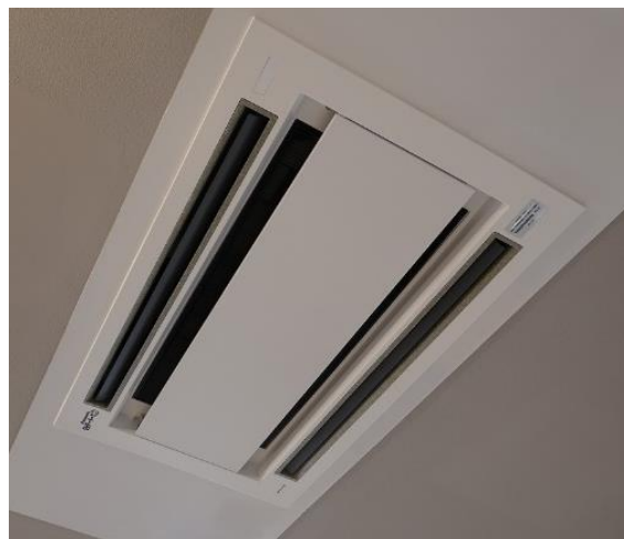
高効率空調 室内機
