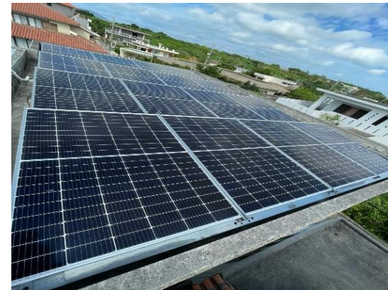
太陽光発電設備②
