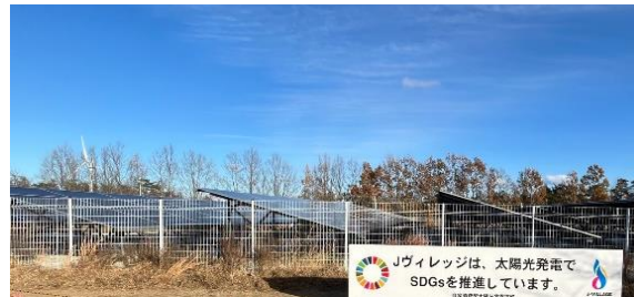
太陽光発電設備①
