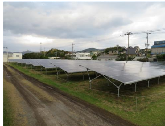
太陽光発電設備
