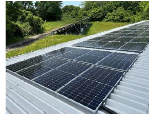
太陽光発電設備
