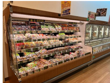
高効率冷凍冷蔵設備
