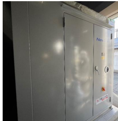
NH 3 /CO 2 冷媒冷凍機
