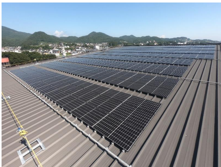
太陽光発電設備
