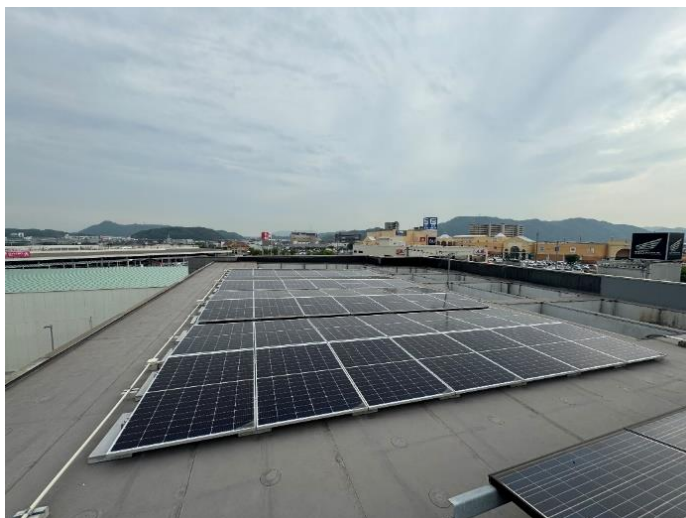
太陽光パネル
