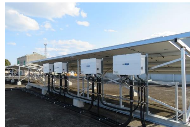
パワコンの設置状況
