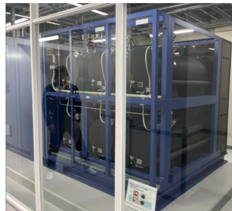
水素貯蔵装置（水素タンク部分）
