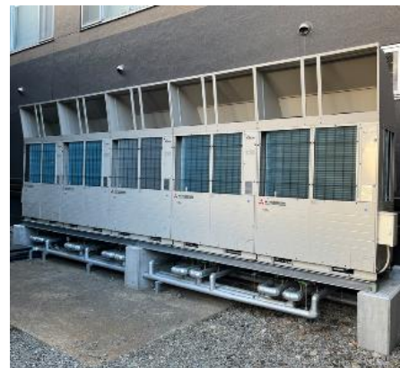
ヒートポンプ給湯機
