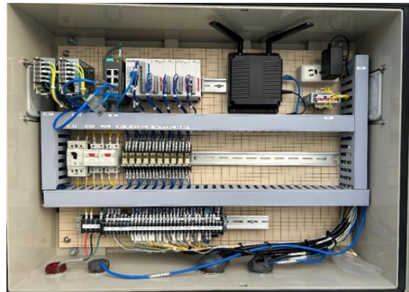
空調最適制御システム（制御盤）
