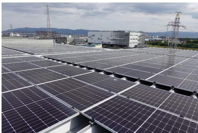
太陽光パネル
