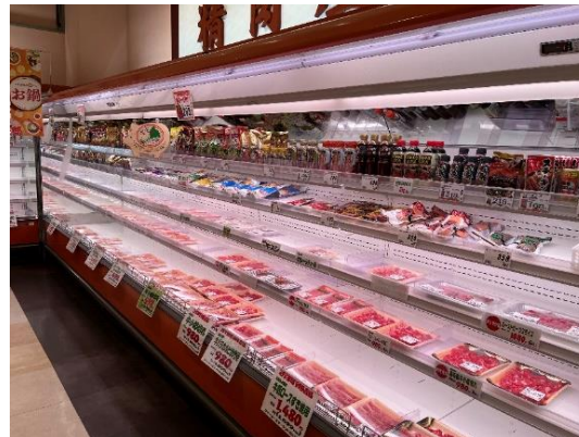
冷凍冷蔵設備
