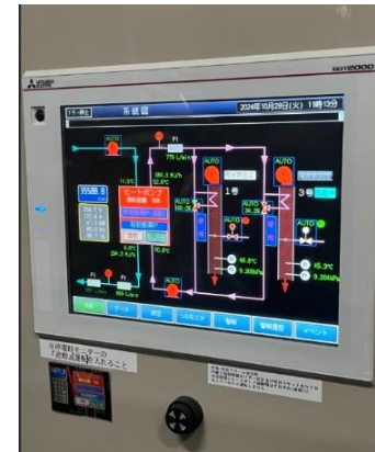
熱回収ヒートポンプ制御盤
