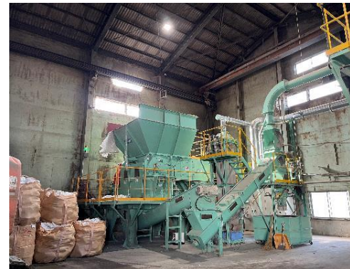
高効率RPF製造設備
