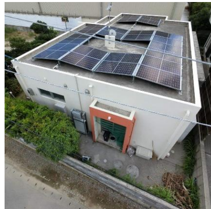
太陽光発電設備①
