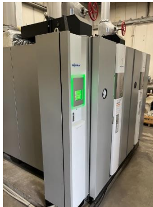
都市ガス式ボイラー設備
