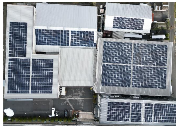
太陽光発電設備
