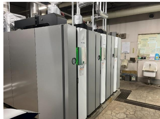
ガス焼き蒸気ボイラー
