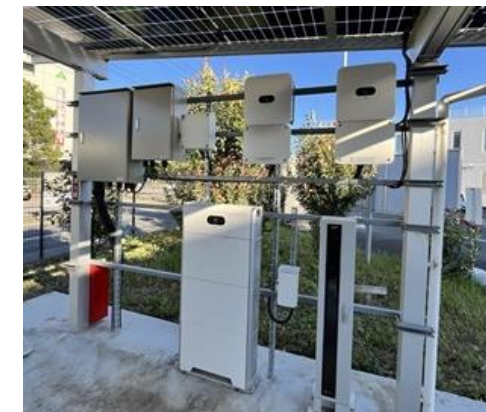
パワーコンディショナー・蓄電池
