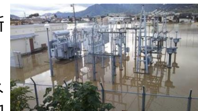
台風により水没した変電所
