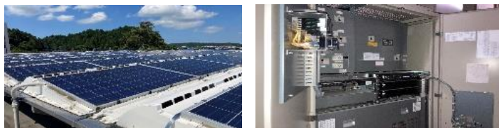
珠洲市役所の太陽光、蓄電池 写真提供：珠洲市
