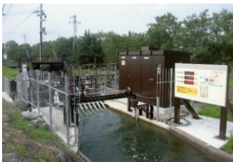
小水力発電設備 (富山県)
