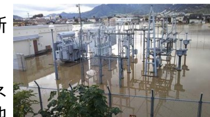
台風により水没した変電所
