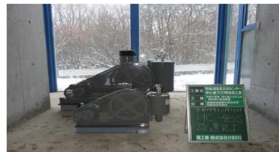
新設ばっ気ブロワ2台 新設調整ブロワ1台
