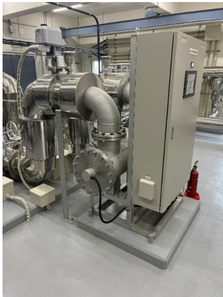
写真1 与井浄水場の紫外線処理設備
