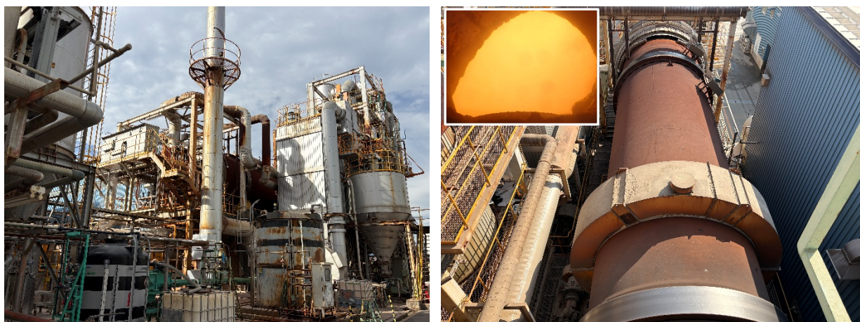
図-1 実証試験に使用する設備
