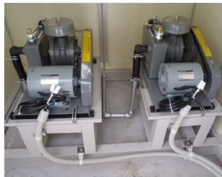
新設ばっ気ブロワ1台、原水攪拌ブロワ1台
