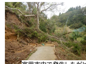
富里市内で発生したがけ崩れ 令和元年10月の千葉県豪雨による被害
