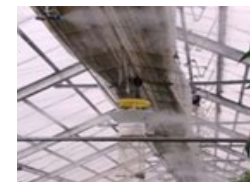
細霧冷房装置
