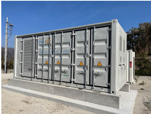
設置された蓄電池
