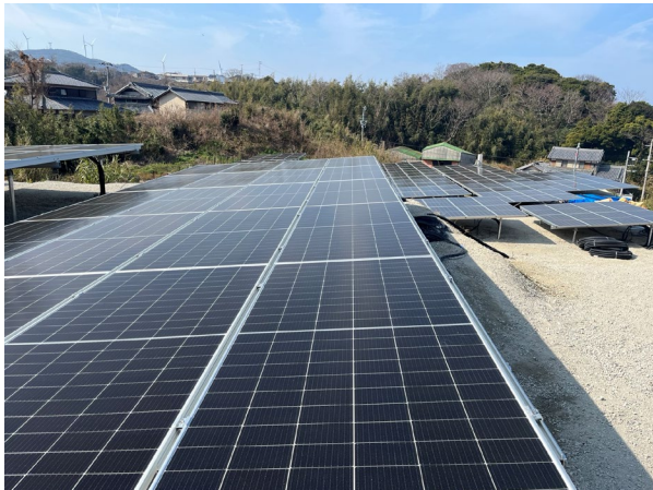
設置されたPVパネル
