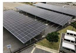
市庁舎駐車場におけるソーラーカーポート（宮古島市）
