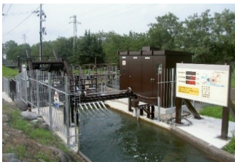
小水力発電設備 (富山県)
