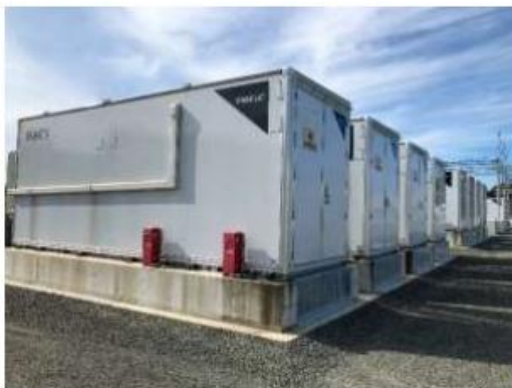
図表 16 系統用の蓄電池コンテナ
