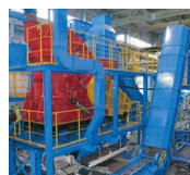
金属破碎・選別設備
