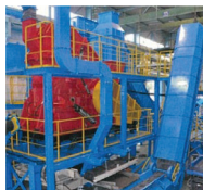
金属破碎・選別設備
