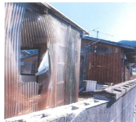
破損した民家
