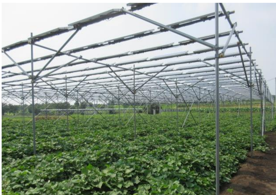
露地の畑の上部にパネルを設置
