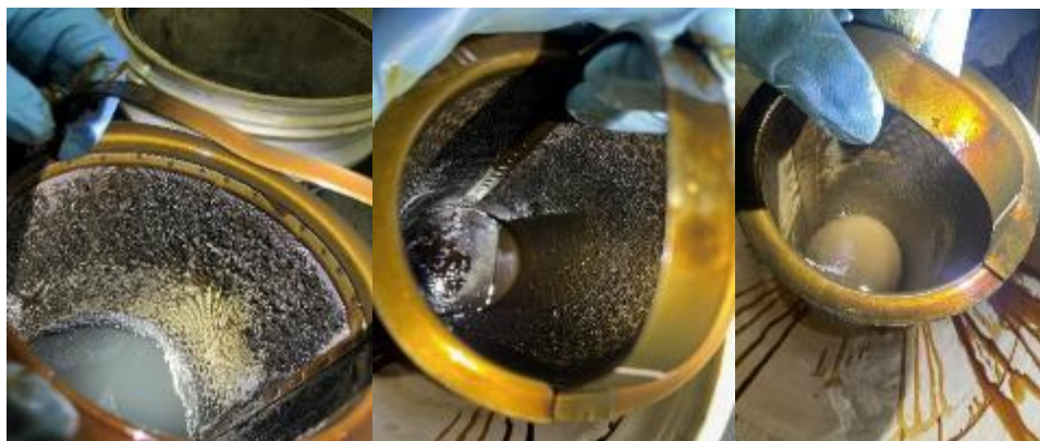
図 39：運航実証開始 208 時間後におけるストレーナー内部 (左より移送ポンプ、燃料清浄機、燃料供給一次)
