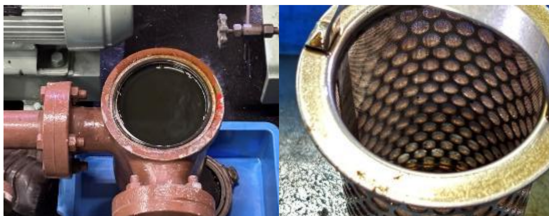
図 53：燃料配管ストレーナー（左）および内部エレメント（右）
