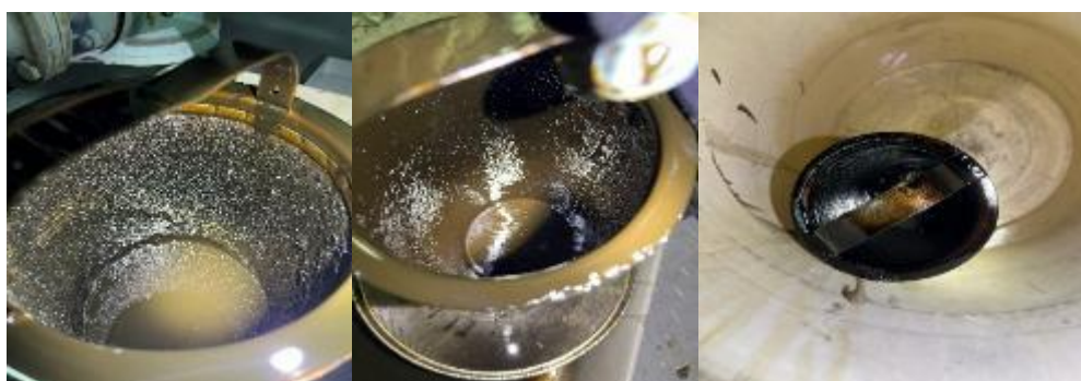
図 33：ストレーナー内部（左より移送ポンプ、燃料清浄機、燃料供給一次）
