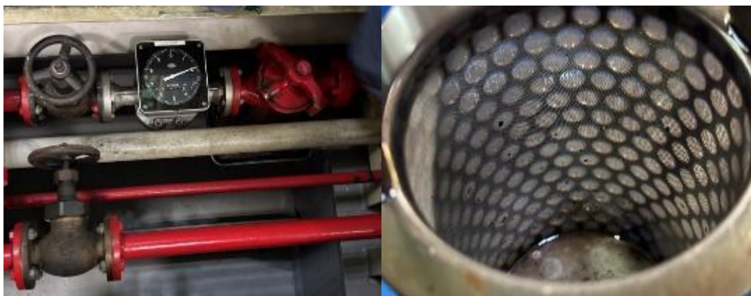
図 54：主発電機関入口ストレーナー（左）および内部エレメント（右）
