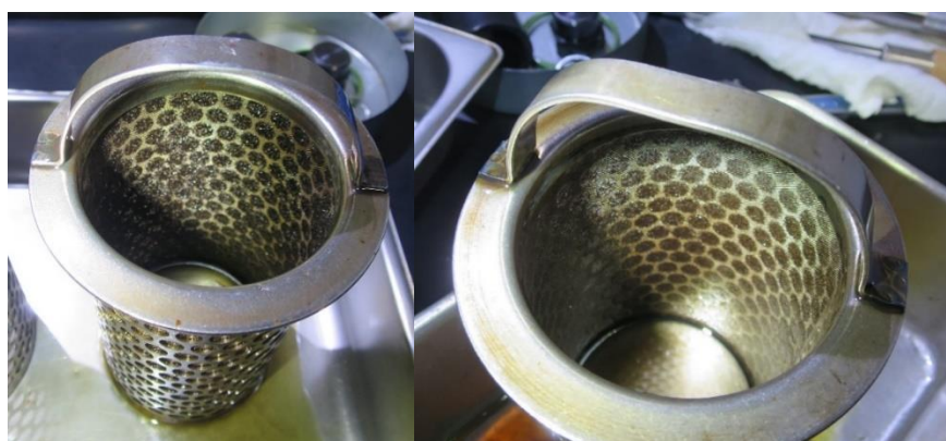
図 66：燃料配管ストレーナー（左）、主発電機入口ストレーナー（右）
