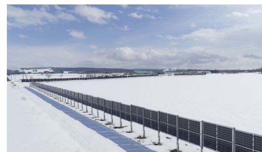
写真 営農地太陽光発電設備の設置状況
