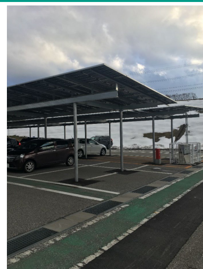
写真 ソーラーカーポート設置状況
