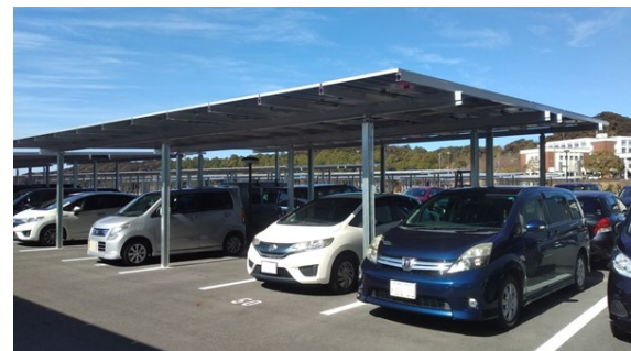
写真 ソーラーカーポート設置状況
