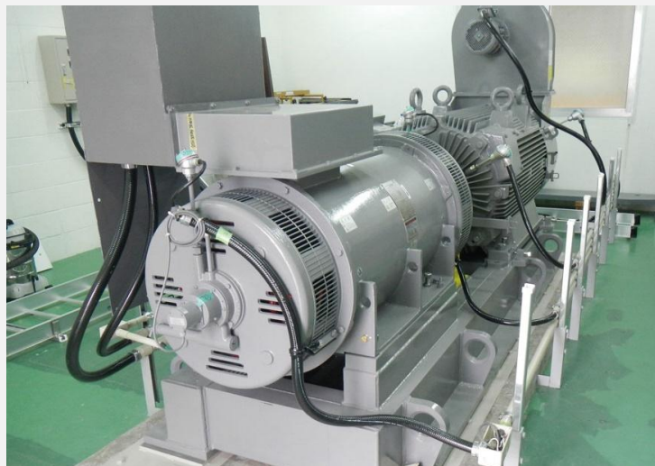
MGセット（奥がモータ、手前が発電機）
