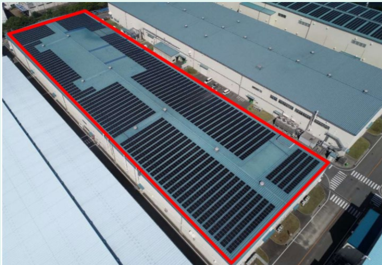
太陽光発電設備
