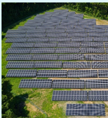
千葉若葉太陽光発電所
