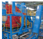
金属破碎・選別設備
