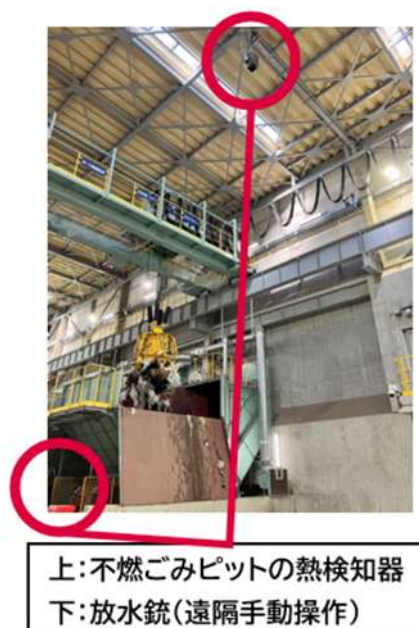
図 4-29 不燃ごみピットの上部に設置された熱検知器と放水銃 出所)調査時に MRI 撮影※赤丸及びテキストボックスは MRI が追記を行った。
