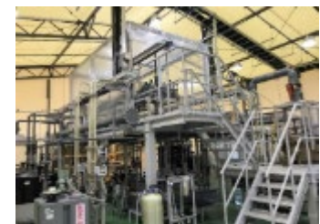
リチウムイオン電池の リサイクル設備
