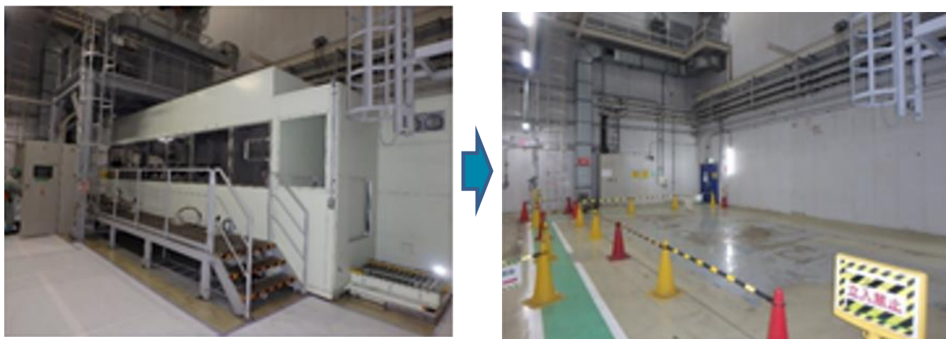
リン含有PCB油前処理設備
