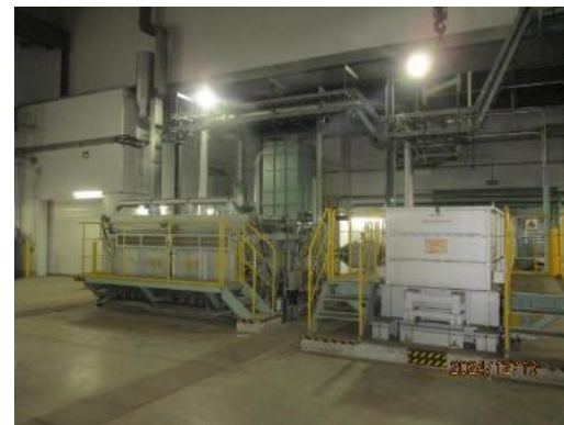
プラズマ付帯設備
