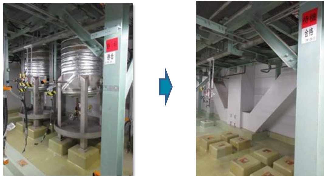
受水槽室タンク類
