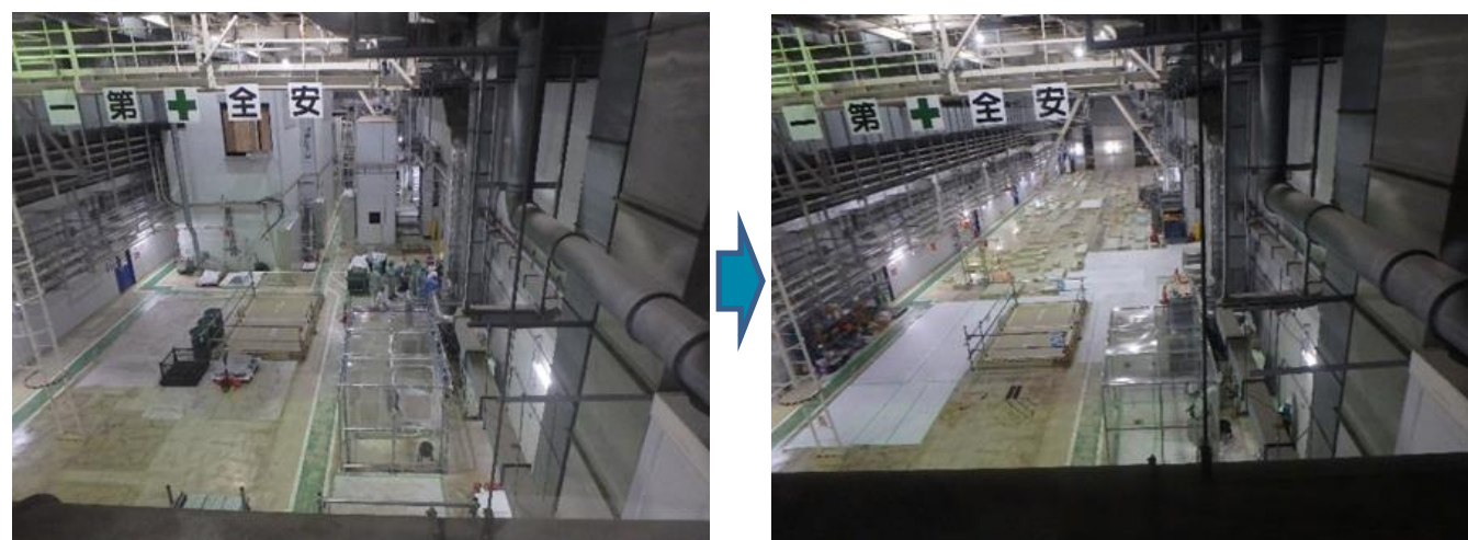
安定器等処理設備
