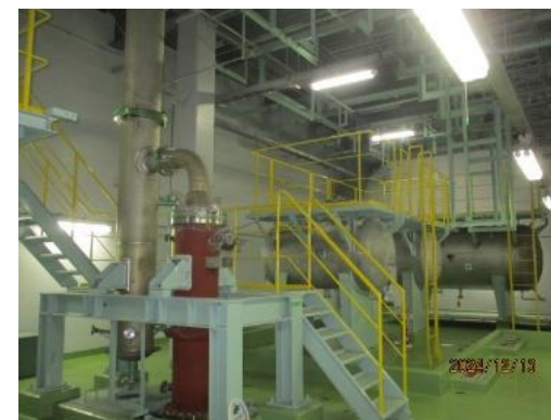
TCB分離・減圧蒸留設備
