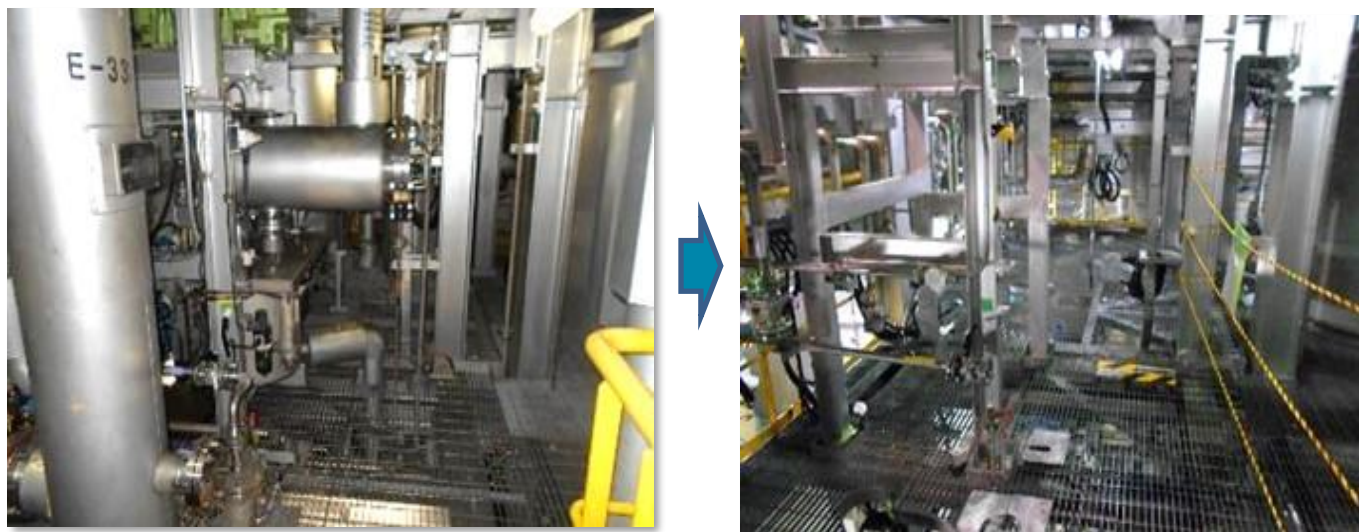
VTR設備D号機
