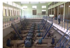
高効率ポンプ (ベトナム)
