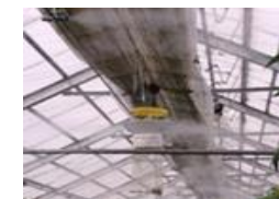
細霧冷房装置
