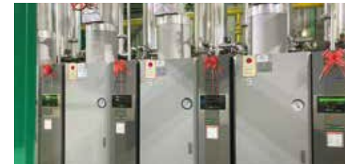
貫流ボイラー (インドネシア) DIC
