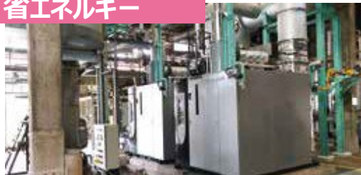
ボイラー・冷凍機・太陽光発電 (タイ) 関西電力
