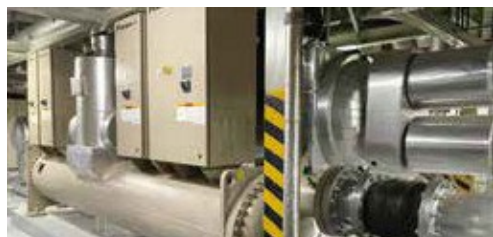
チラー・空調機・太陽光発電 (インドネシア) 裕幸計装
