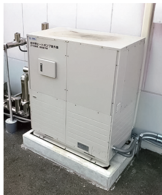
地中熱利用ヒートポンプ（室外機）
