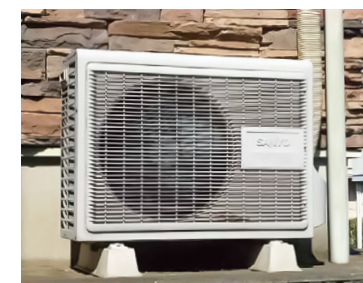
空気熱源ヒートポンプ
