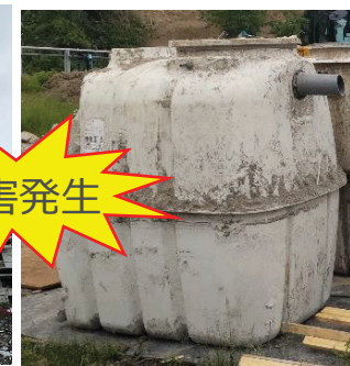
被災した浄化槽
