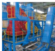
金属破碎・選別設備
