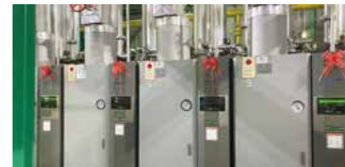
貫流ボイラー (インドネシア) DIC
