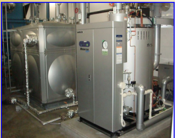
飼料法に基づき加熱殺菌をして保管タンクへ(BDF100を燃料としたボイラー使用)
