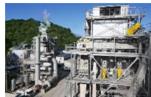
鶏糞燃焼発電ボイラー
