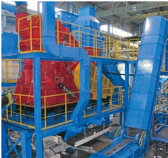
金属破碎・選別設備
