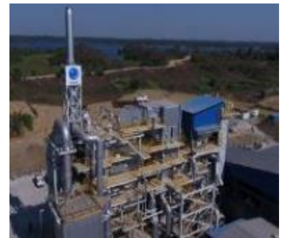
ミャンマー初の 廃棄物発電施設
