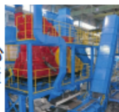
金属破碎・選別設備
