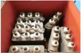
鋼製容器への収納例
