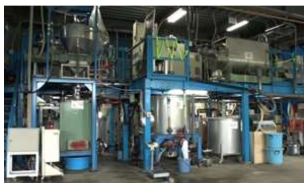
図 5-7 再生利用等設備の概観（実証施設）
